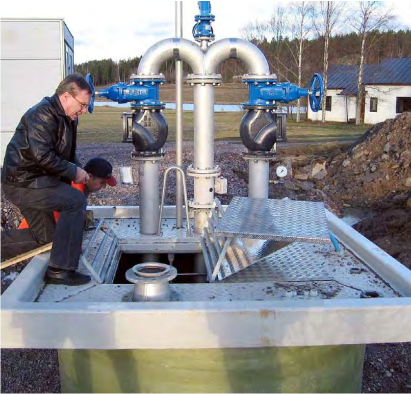
Paineenkorottamot ja jätevedenpumppaamot on mahdollista toteuttaa automaation osalta kokonaan ilman logiikkapohjaista paikallisautomaatiota. Kaikki säätöohjelmat on sijoitettu taajuusmuuttajien sisälle.
