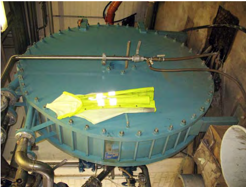
Kuva 5. Mädättämöstä tulevan lietteen lämpöä hyödyntävä spiraalilämmönvaihdin (Hämeenlinnan Seudun Vesi). (Kuva: Tuija Tukiainen)
