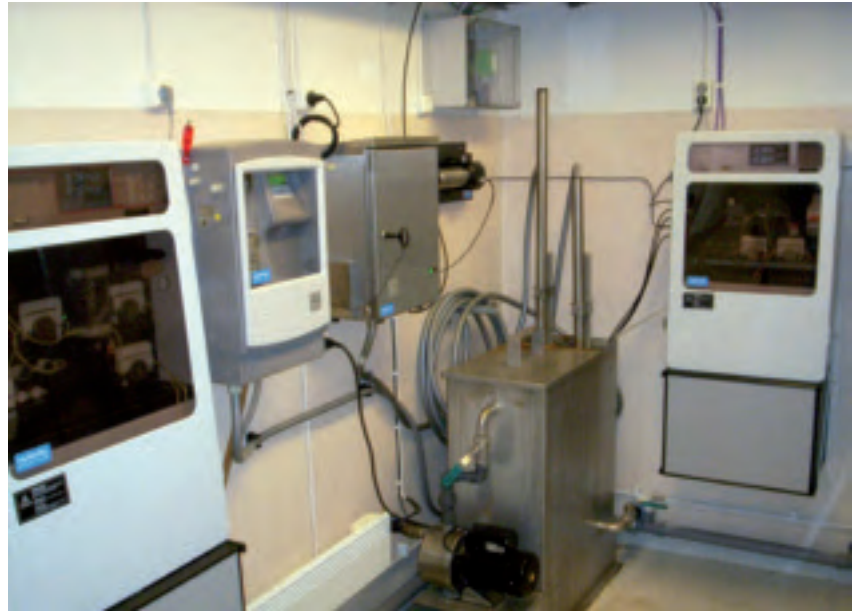
Kuva 2. Jatkuvatoimisia fosforianalyysejä sekä automaattisia näytteen esikäsittely- ja suodatusyksiköitä.
