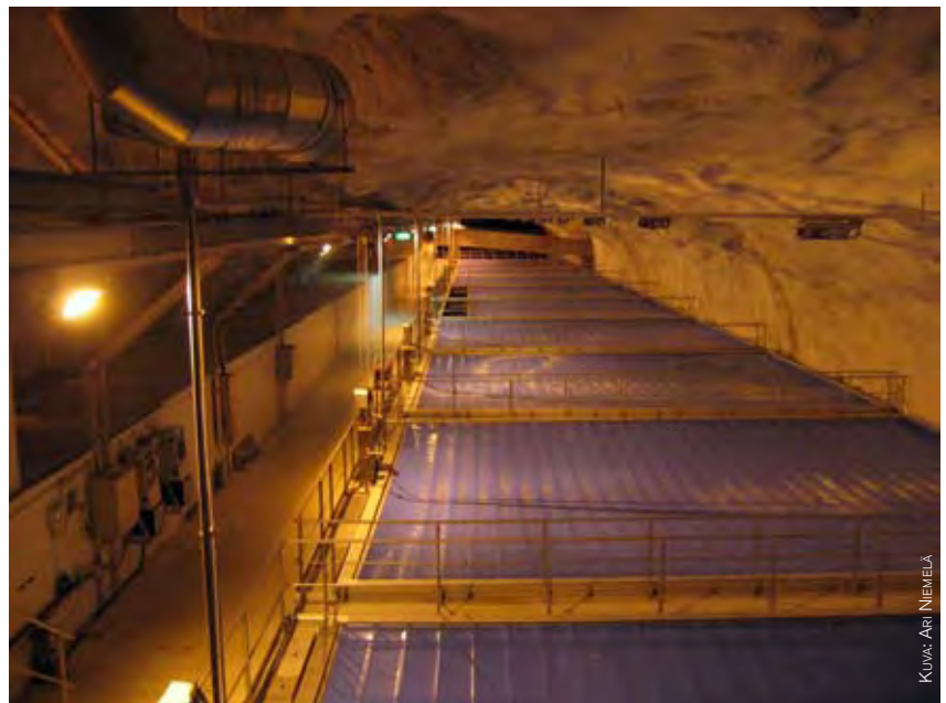
Uusikaupunki, Hapönniemen jätevedenpuhdistamo, tekninen käytävä.
