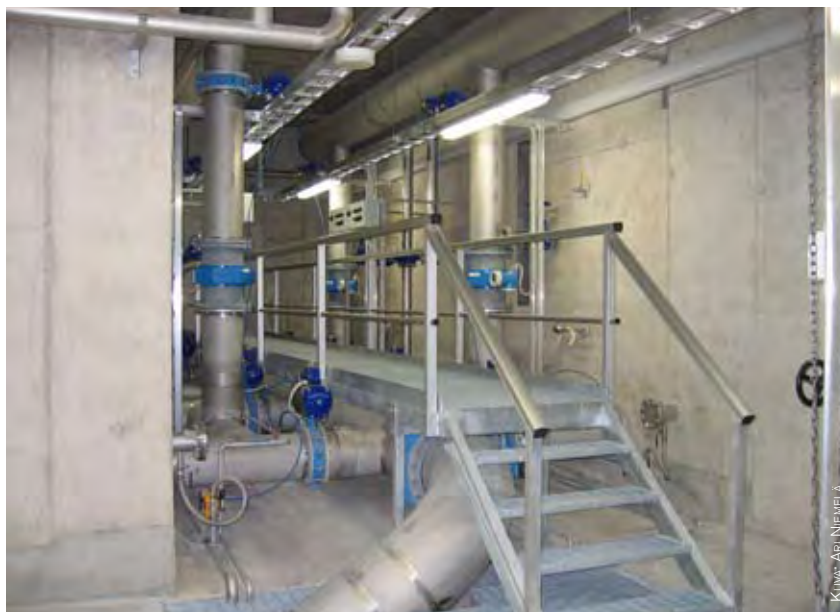
Helsinki, Viikinmäen jätevedenpuhdistamo, suodattimet kallion sisällä.
