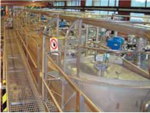
Kuva 3. Panostoiminen Kemicond- prosessi toteutettiin Käppälässä 750 000 avl:n laitokselle neljällä 30 m 3 :n sekoitusreaktorilla. Ouluun rakennettavassa jatkuvatoinimisessa prosessissa tarvitaan kaksi 20 m 3 :n reaktoria. Kuva: Kemira Oyj.
