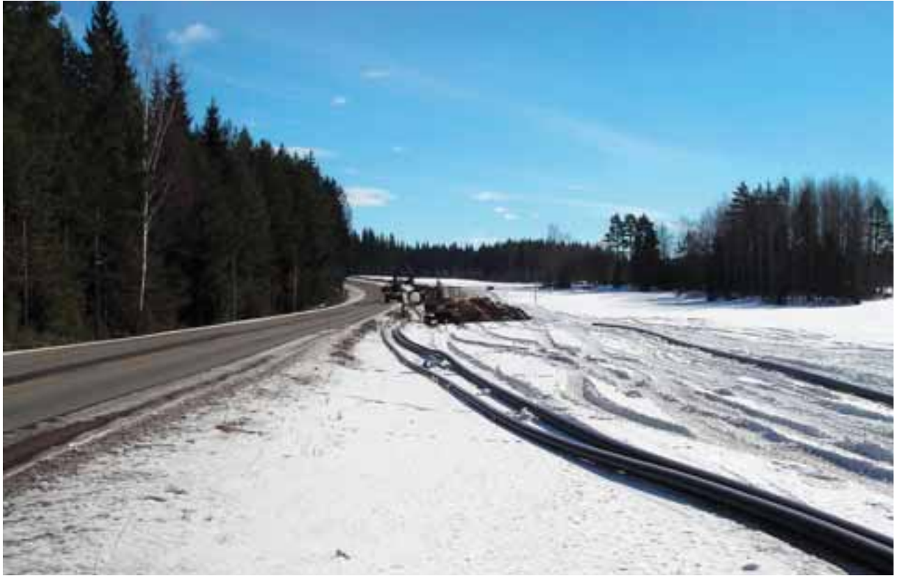
Kuva 3. Hämeenlinnan seudulla on runsaasti positiivisia kokemuksia alueellisesta vesihuoltolaitoksesta. Siirtoviemäri Hauholta Hämeenlinnaan oli taloudellista toteuttaa, kun jätevesilaskutus kuntien rajalta loppui. Kuva: Hämeenlinnan Seudun Vesi Oy.
