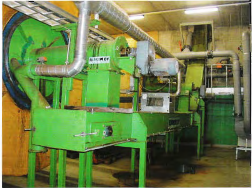
Rumpujen purkuruuvit, joiden alla kolakuljetin, joka siirtää kompostin valmistuotevarastoon.
