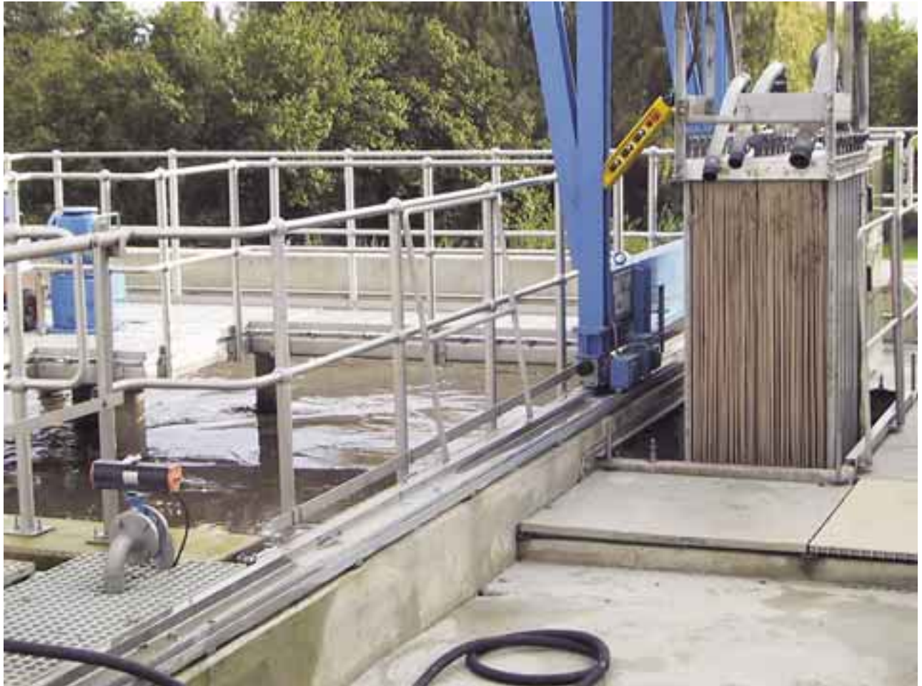
Kuva 3. Kalvosuodatin-elementti nostettuna ilmastusaltaasta. (Kuva: Risto Saarinen)
