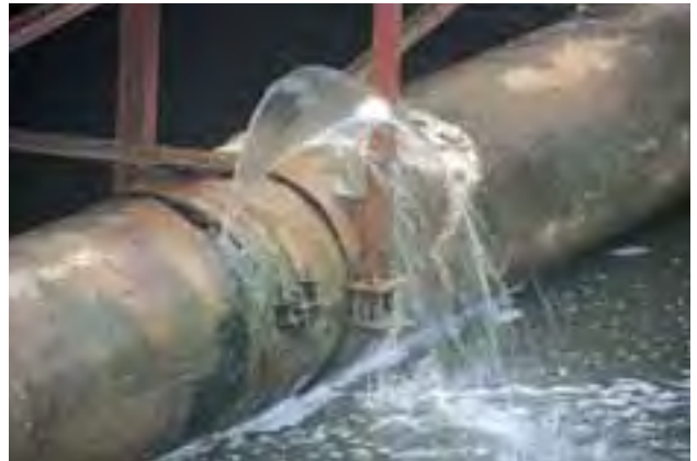
Vuotavat vesiputket ovat kehitysmaiden kaupungeissa arkipäivää. Haiphong, Vietnam.
