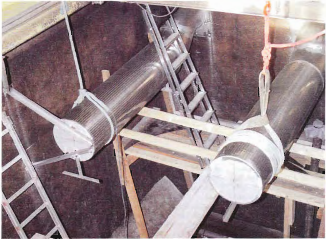
Kuva 6. Kiilalankasiivilät toisessa ilmastusaltaassa.
