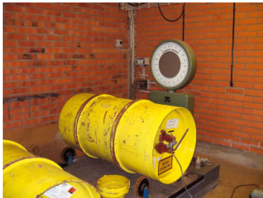
Kuva 2. Kloorisäiliö asennettuna vaa'alle Tampereen Ruskon vesilaitoksella.
