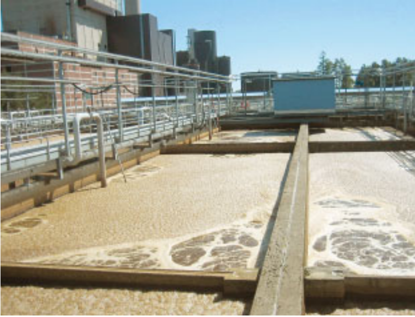
Kuva 2. Suomenojan jäteveden-puhdistamo toimii edelleen laadukkaasti, mutta kapasiteetti on loppumassa Espoon nopean väestönkasvun seurauksena.
