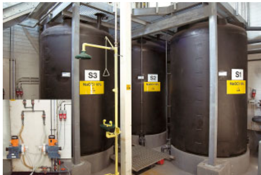
Kuva 4. Uudet hypokloriittisäiliöt ja pikkuruudussa syöttöpumput Espoon Dämmanin vesilaitoksella. Säiliöt sijaitsevat jäähdytetyssä tilassa.
