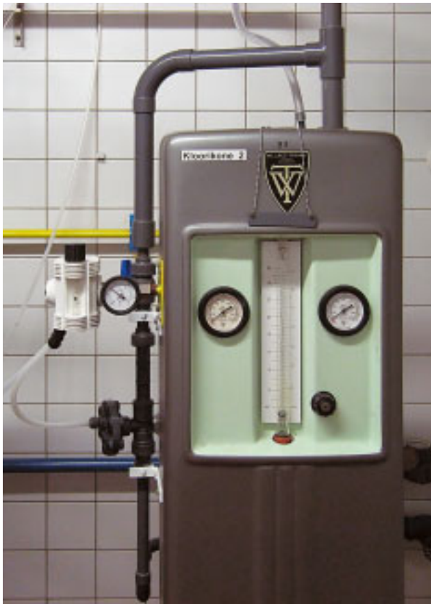
Kuva 3. Klorinaattori Ruskon vesilaitoksella.
