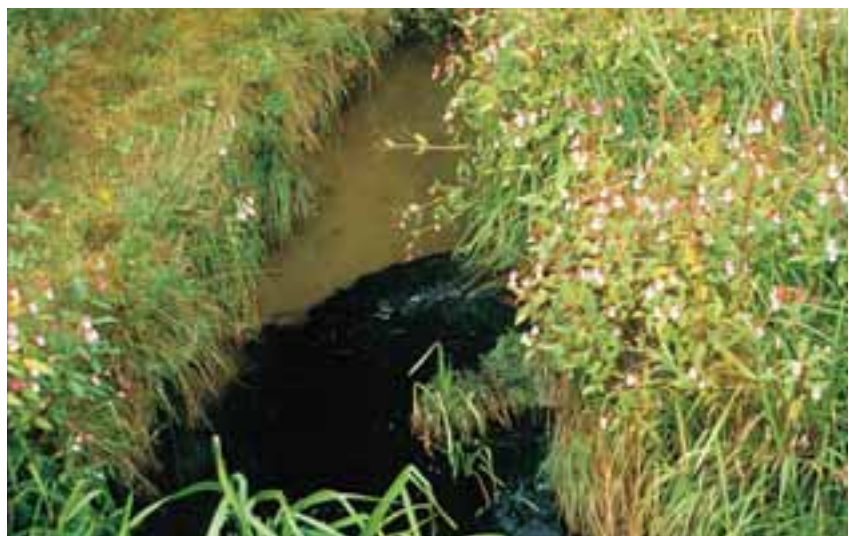
Kuva 2. Rikkoutunut jätevesiviemäri mustaa Mellunkylänpuron vettä Itä-Helsingissä.
