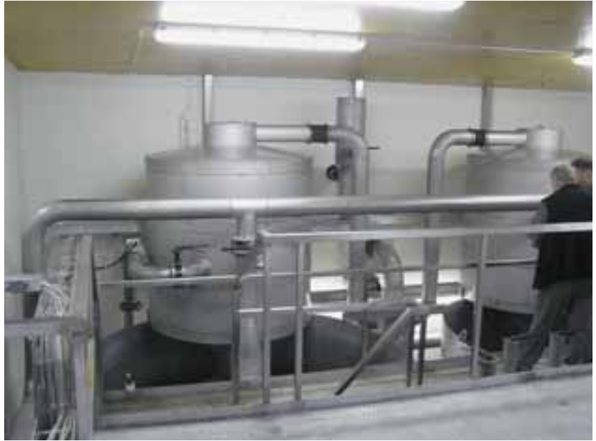
Kuva 2. Karjaan kaupungin Maasilan vedenottamon NWF-laitos
