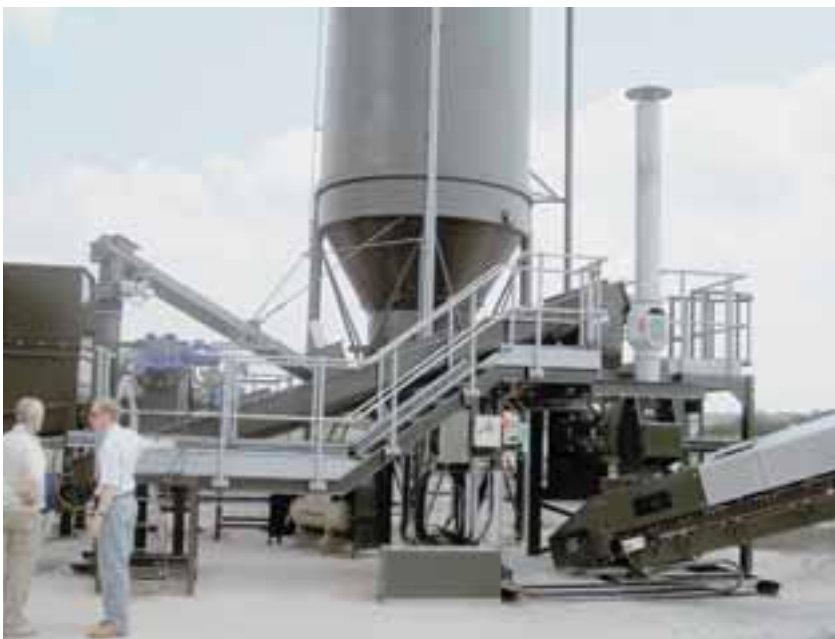
Kuva 3. Kalkkistabilointilaitteisto. (Kuva: Mari Piispanen, Nordkalk)
