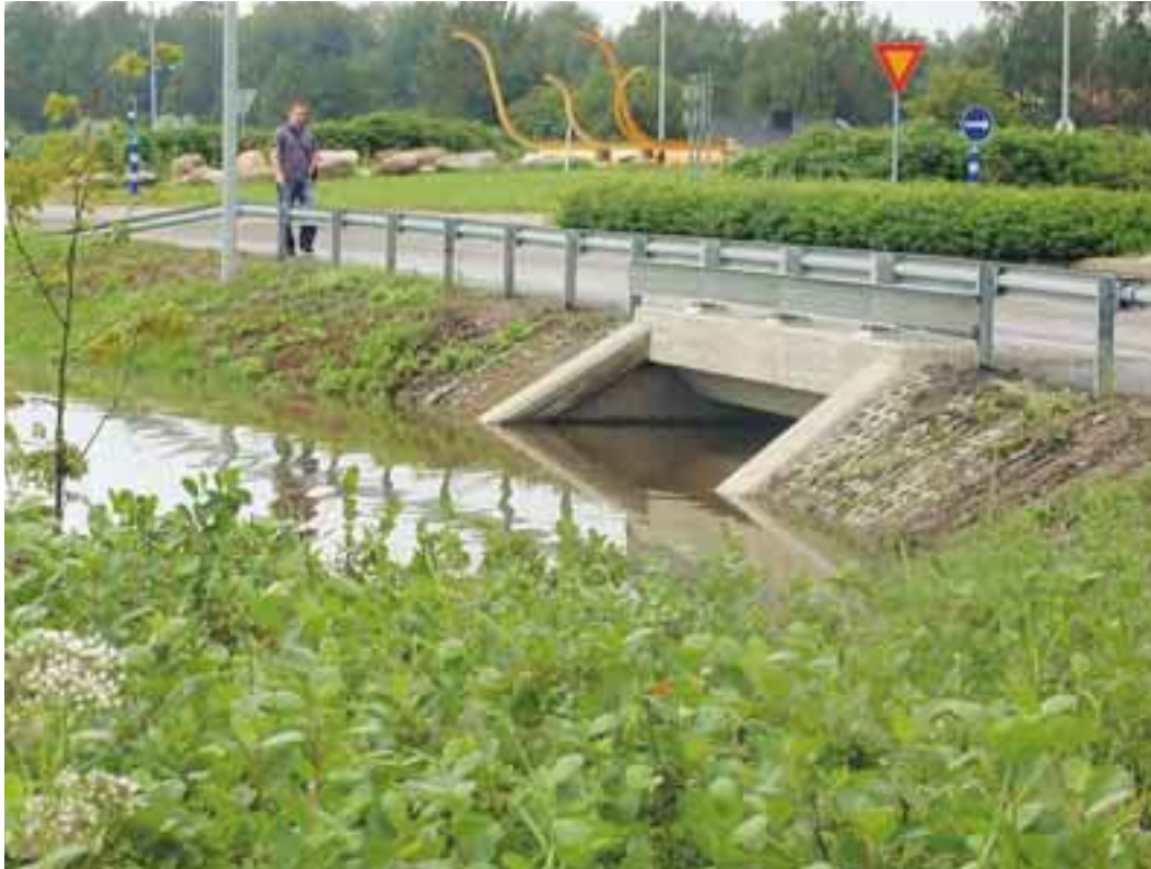
Kuva 1. Tulviva Ouluntien alikulutunneli (Kuva: Ylivieskan kaupunki)
