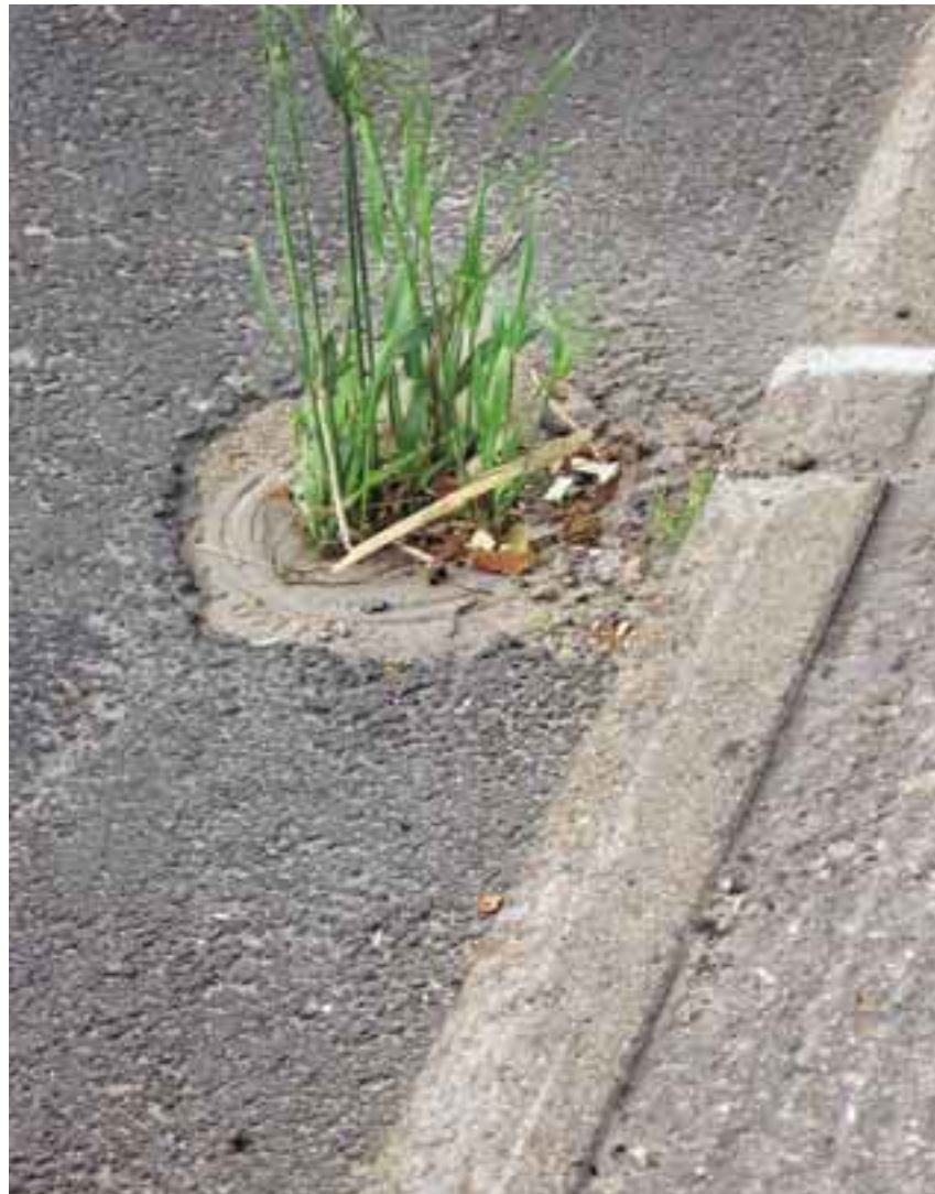
Kuva 2. Kasvillisuuden tukkima hulevesikaivo (Kuva: Mikko Kajanus)
